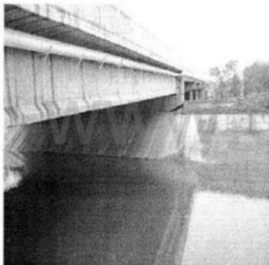
桥面下部雨水收集横管
